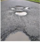
File:Potholes.jpg - Wikime... commons.wikimedia.org
